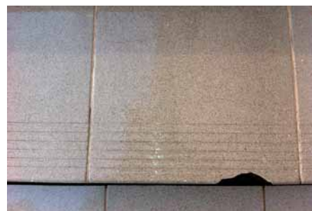
Poškodená dlaždica na schodisku – odštiepený okraj
